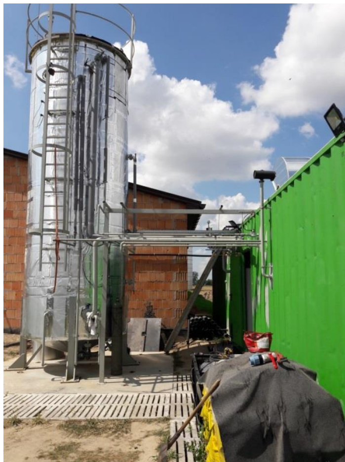
Rys. 14. Reaktor przepływowy monosubstratowy do fermentacji metanowej gnojowicy wraz z instalacją do produkcji biogazu -widok [fotografia G. Wałowski].
