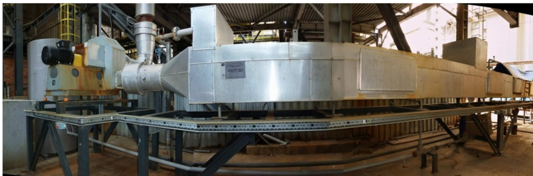
Rys. 4. Stanowisko pilotowe zainstalowane w PGE GiEK SA Oddział Elektrownia Bełchatów
